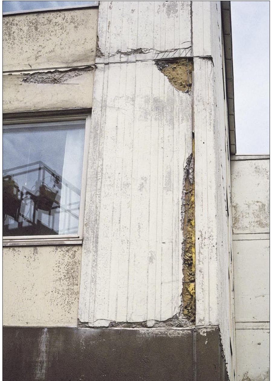
Rikkoutuneista elementtisaumoista sisään tunkeutuva vesi aiheuttaa vaurioita koko talon rakenteille.
