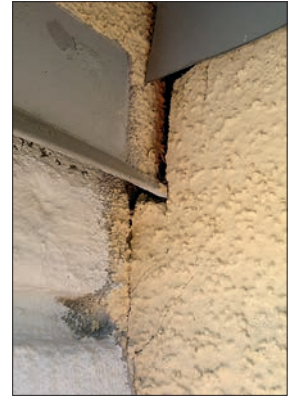
Pellit on asennettu liian aikaisin.
