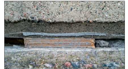
Elementin asennuspalat on poistamatta.
